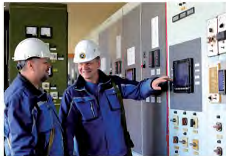
На ЦПУ котельной. Начальник цеха №19 Азат Исмагилов и и. о. главного теплотехника Андрей Симонов обсуждают работу новых приборов
